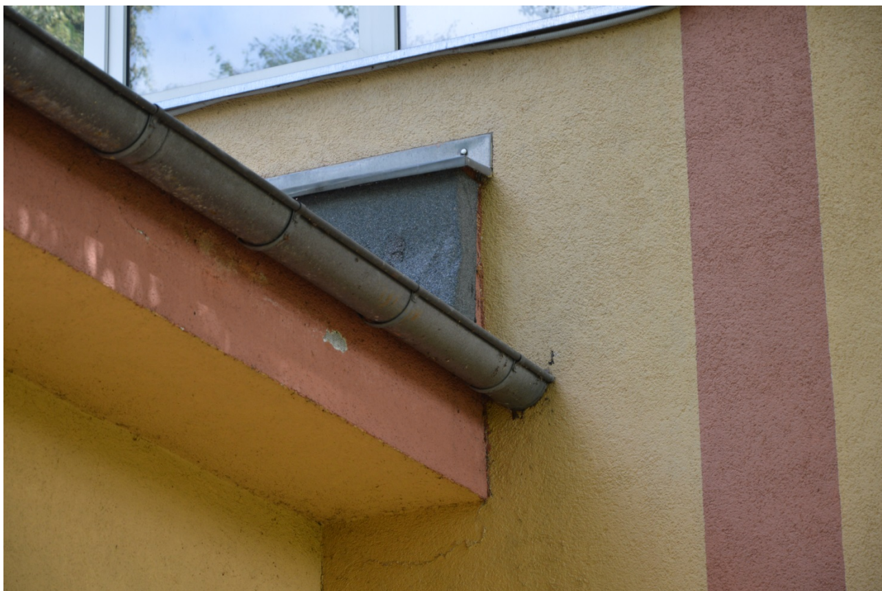
8. Obróbka blacharska i rynna budynku sanitarnego przyłączeniu z salą sportową.
